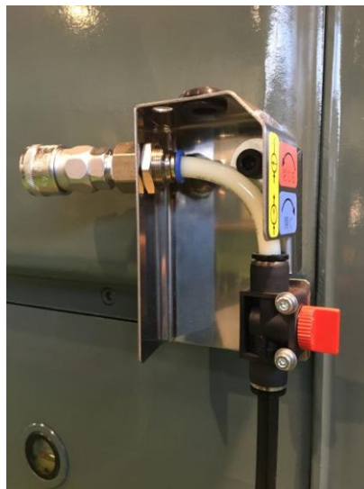
写真 2 供給部 バルブ側
