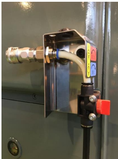
写真 2 供給部 バルブ側
